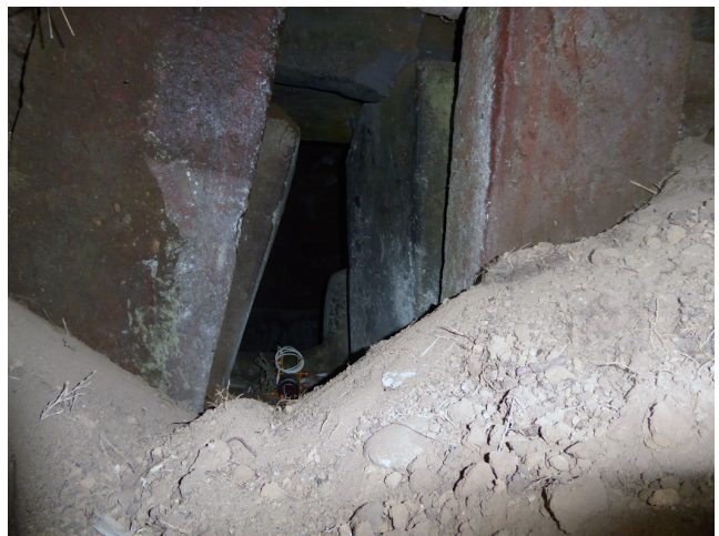
熊本地震で被災した井寺古墳内部
