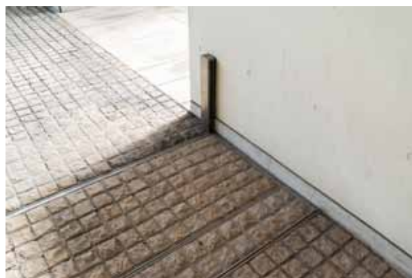
海に近い館での防潮板の設置状況
