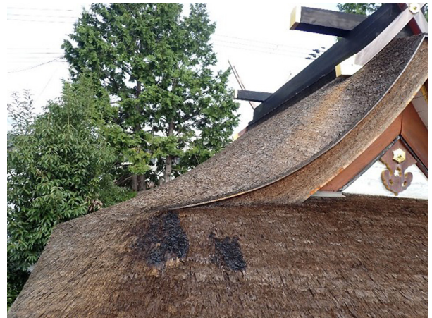
文化財建造物の防火対策に関する調査 飛び火を受けた檜皮の事例(崇道天皇社)
