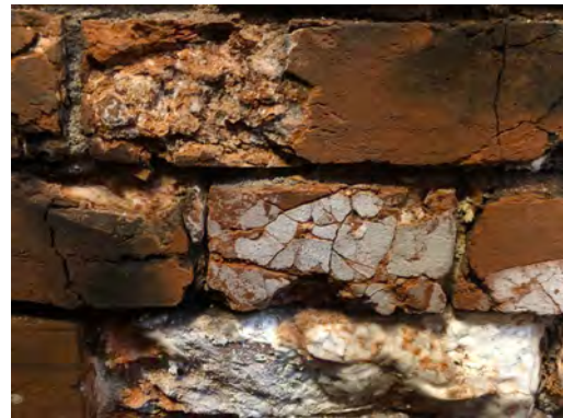
図2 内部の金属の腐食に伴う煉瓦の亀甲状の割れ
