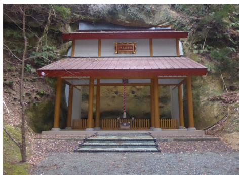
東日本大震災で一度倒壊した後、再建された史跡・薬師堂石仏の覆屋
