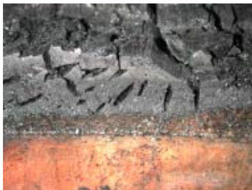
焼損木材の断面：内部まで亀裂が入っている
