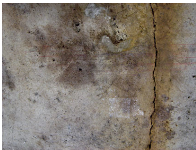
写真3 天井部の褐色の着色（2007年8月10日） （写真提供：川野邊渉）
