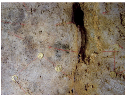
写真1 天井の漆喰表面に発生したカビの例（2007年7月24日）
