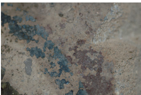
写真8 N(a)窟 薄い壁土の下から現れた細かいうろこ状に亀裂を生じた絵具層
