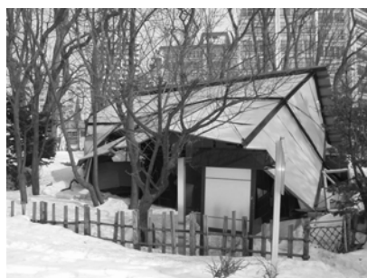
写真2 倒壊したプレハブ上屋
