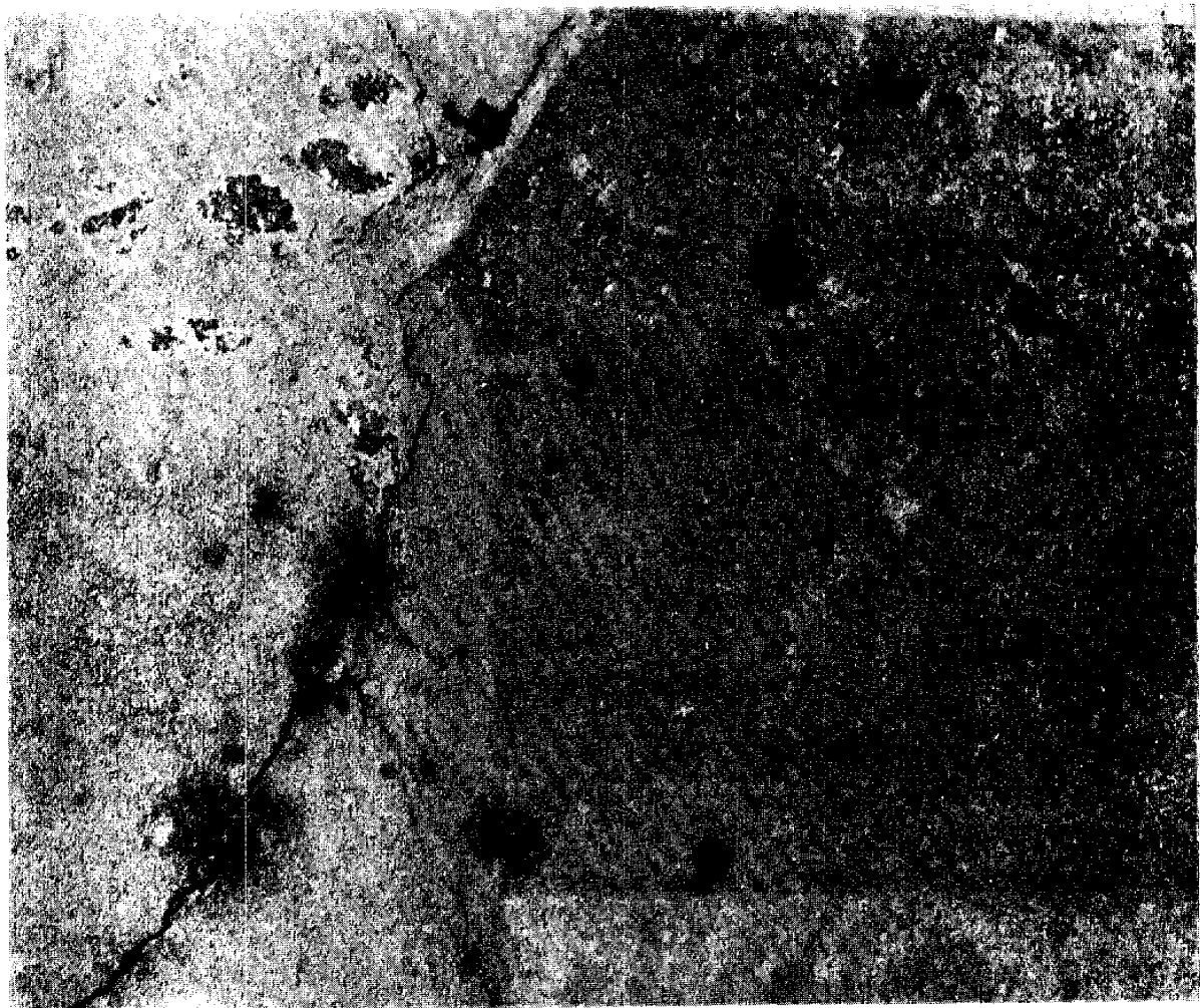
第3図 第1号壁に発生した集落は防黴剤を吹付けた後に黒斑として残る。左方亀裂に沿う3個の黒斑は既にあったものでその下のは削り取った残痕(第1図のもの)。両者を比較すると共に酷似するのを見る。
