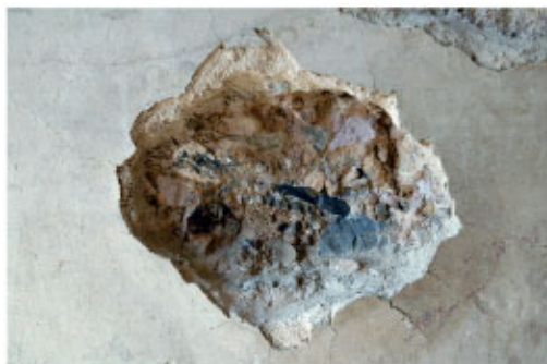
写真3 銃弾の打ち込まれた跡 処置後
