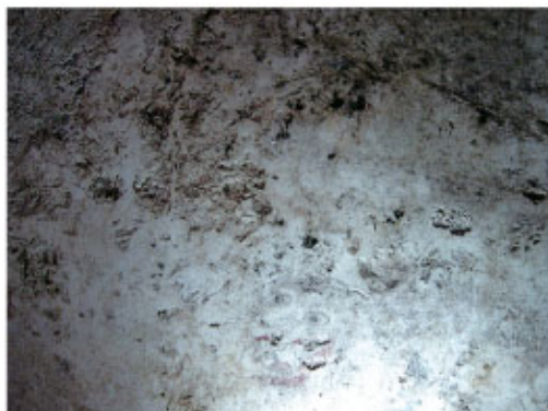
写真4 2006年5月17日 西壁白虎上部の黒いカビ
