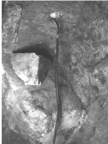
写真8 2006年5月17日 取り合い部(東側)の様子
