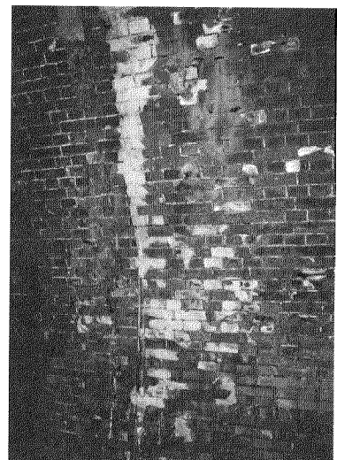
写真2 群馬県碓氷峠鉄道施設第六トンネルに見られる凍結破碎
