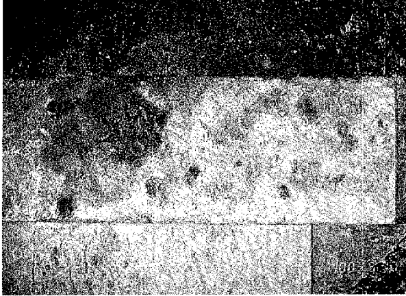
図3 ビフォーマーを塗布した部分だけ白く、緑色生物が観察されない。(施工箇所B)
