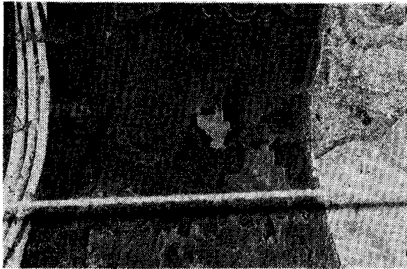
図-9 昭和29年に剝落止め処置が行なわれたと見られる部分。彩色層がやや固く、ひび割れが細い。
