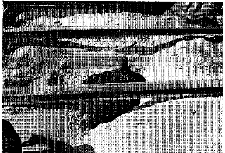
図-2 崩壊部分の状況
