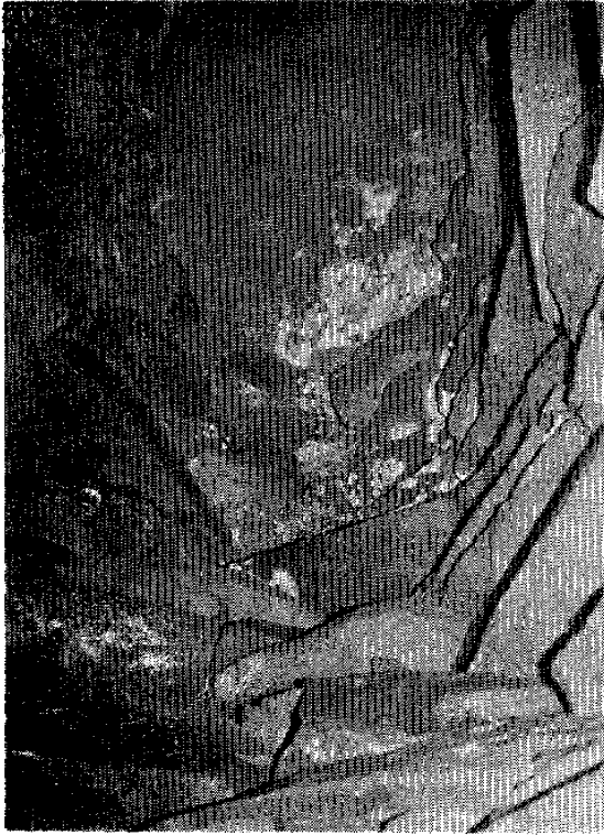
図—9 天井部石組に発生した微生物 コロニー
