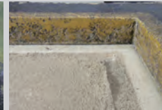
5. 構造内部にたまった泥汚れ
