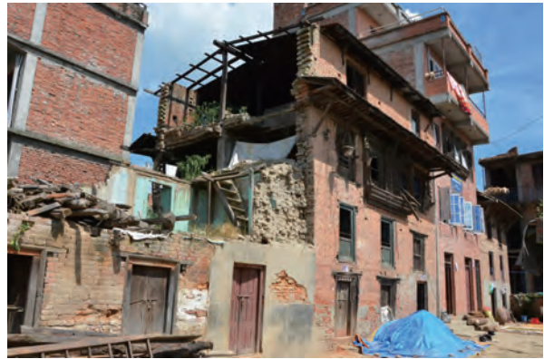
図 2-20 コカナの被災状況
