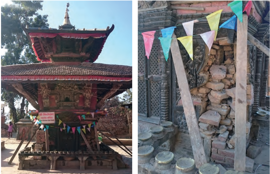
図4-4 木造の柱により倒壊を免れた建物（チャング・ナラヤン）
