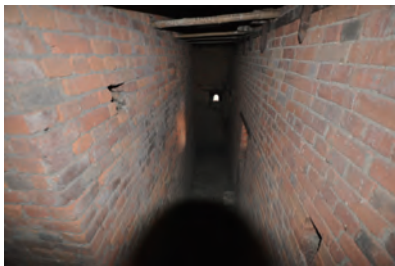
2層：内壁－外壁 被害軽微
