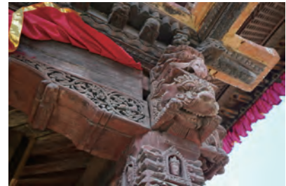
横架材の抜け出し
