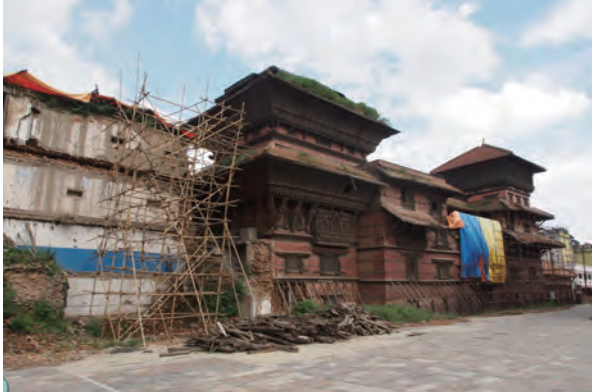
図2-24 ナサル・チョク〜ローン・チョク外周の破損状況
