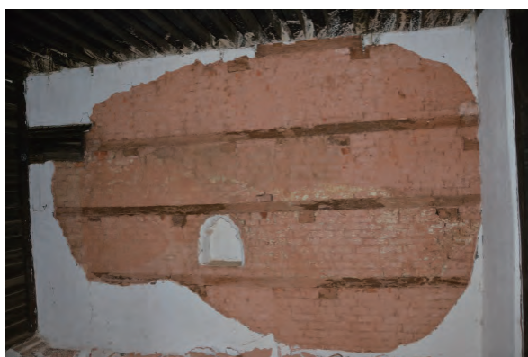
図2-14 漆喰が剥がれ露わになった壁内部の木材
