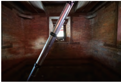
3層外周壁（被害軽微）
