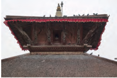
最上層：煉瓦壁の被害
