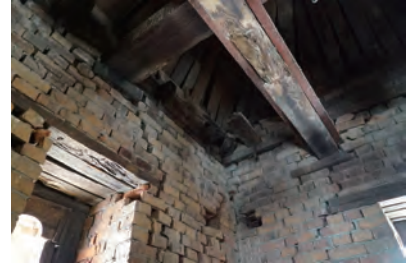
最上層：横架材切欠からの亀裂2
