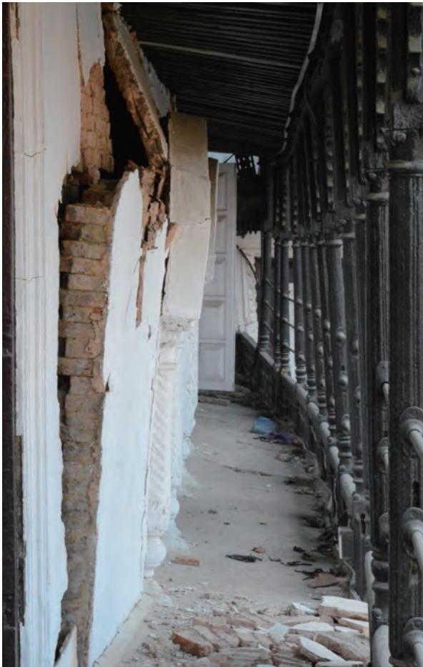
図2-26 モハン・チョク3階ベランダの破損状況
