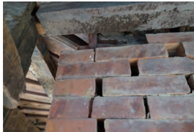
1層外周壁 目地の被害
