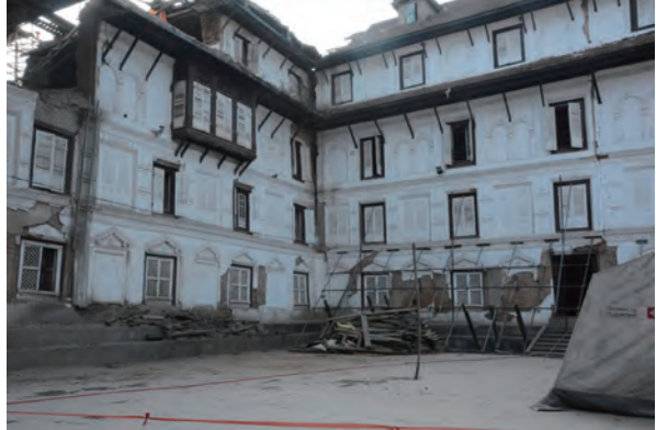
図2-25 ナサル・チョク内周の破損状況
