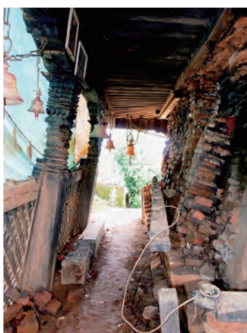
図3-16 東側煉瓦壁 西側へ大きく傾き、外壁表面のダチアバは崩落
