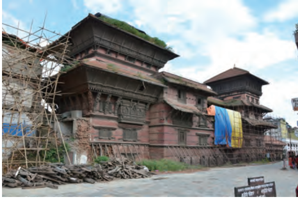
図 2-1 7～9 階部分が崩落したバサンプル・バワン
