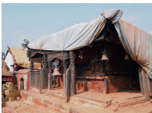
図3-14 バイラブ寺外観(隅柱は欠損したが全壊を逃れた)
