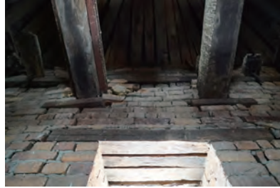
最上層：横架材切欠からの亀裂1
