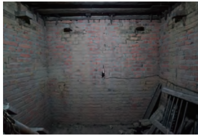
2層内周壁（被害軽微）
