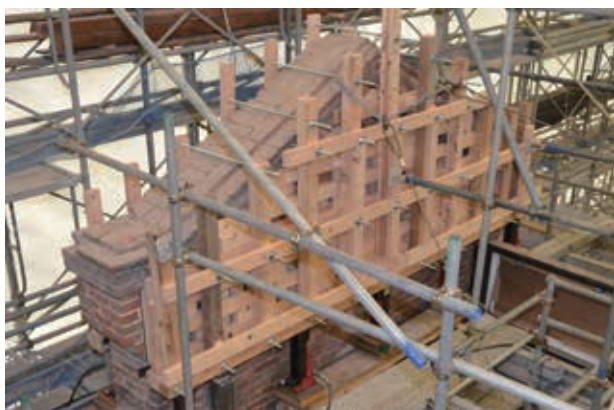
写真1：シャトーカミヤ旧醸造場施設の据え直しをする亀裂壁面の養生（出典：重要文化財シャトーカミヤ旧醸造場施設保存修理工事（災害復旧）報告書）
