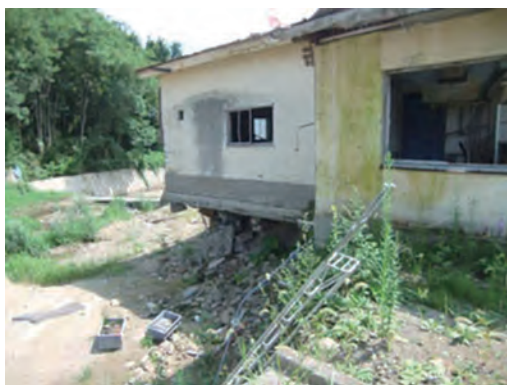
北町収蔵庫母屋の被災状況
